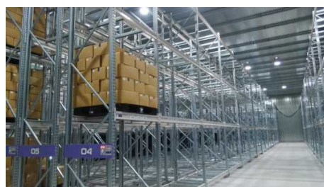
自動保管冷凍庫（内部）
